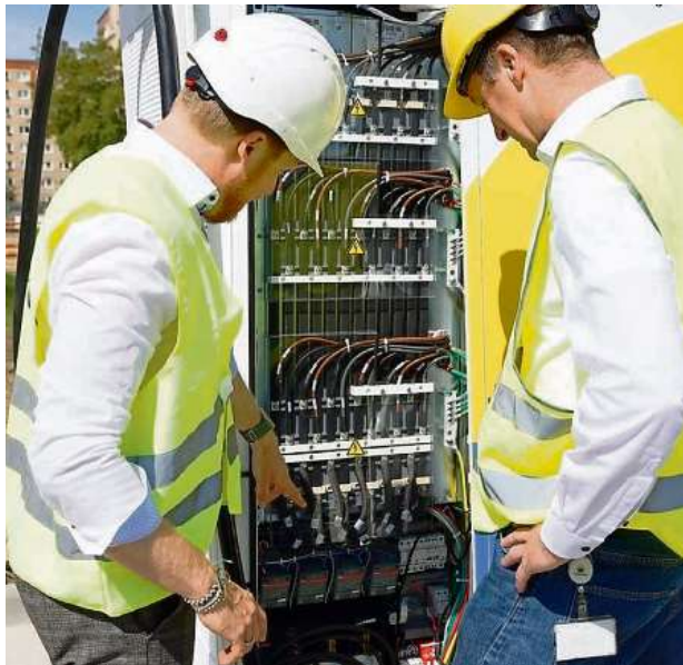
Am Heizkraftwerk Marzahn nahm der Energieversorger Vattenfall seinen ersten öffentlichen Ladepark in Betrieb. Foto: Vattenfall
