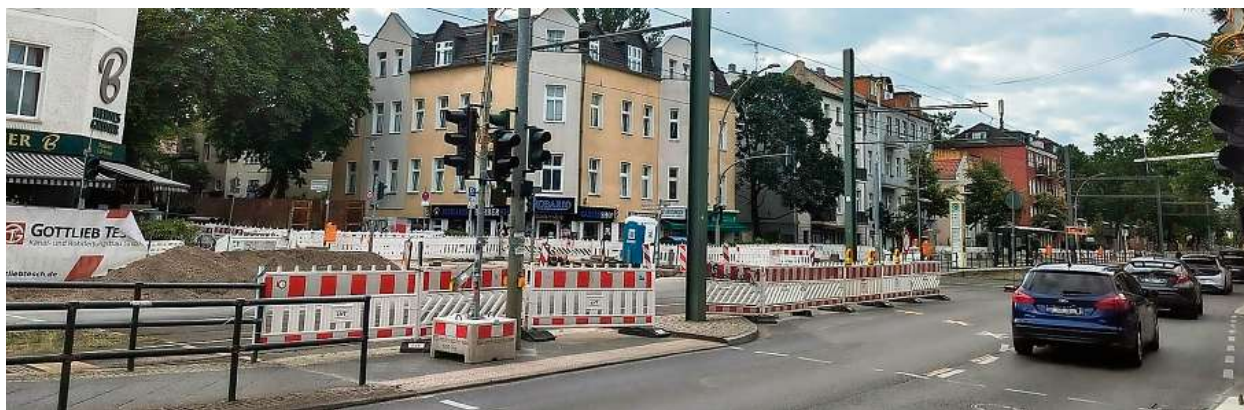
Immer wieder stehen rot-weiße Absperungen auf der Treskowallee. So kennen Anwohner und Nutzer die Straße seit vielen Jahren. Foto: Büro Lilia Usik
